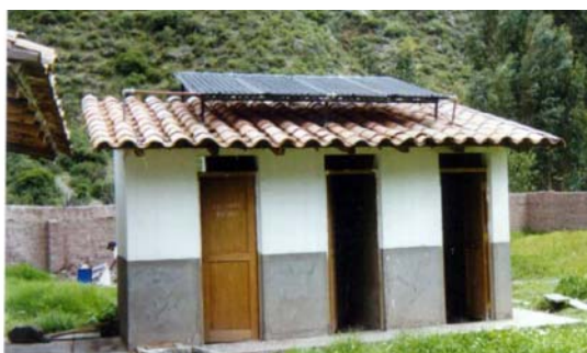
Fotografía N° 02: Vista panorámica del sistema con paneles solares artesanales.
