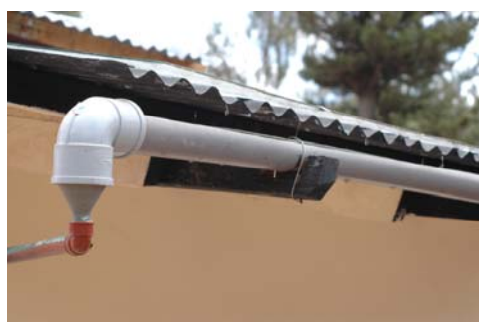
Fotografía N° 09: Sistema de recolección del agua caliente
