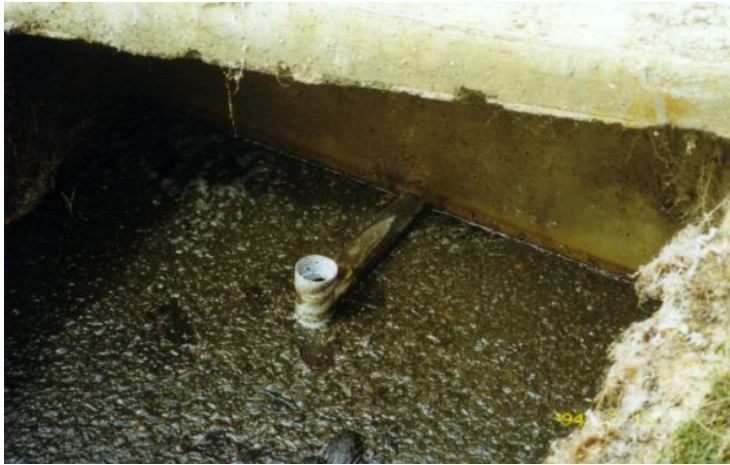
Tanque interceptor en funcionamiento
